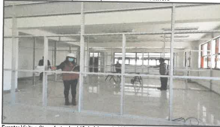
Imagen n.º 6 Vidrio templado incoloro de 10 mm de espesor no instalados en mamparas del primer nivel del edificio
