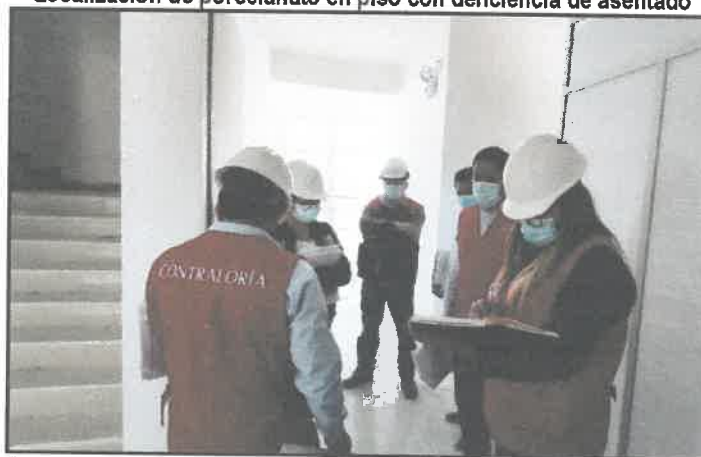
Imagen n.° 17 Localización de porcelanato en piso con deficiencia de asentado
