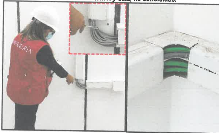
Imagen n.º 29 Instalación de canaletas de cableado de redes de internet y data, no concluidas.
