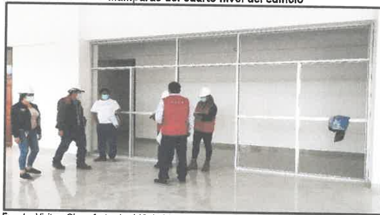
Imagen n.º 7 Vidrio templado incoloro de 10 mm de espesor no instalados en Mamparas del cuarto nivel del edificio
