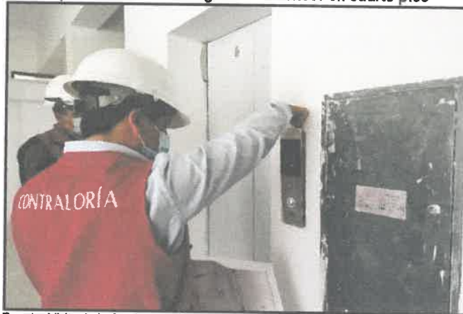
Imagen n.° 16 Apertura de tablero digital de ascensor en cuarto piso
