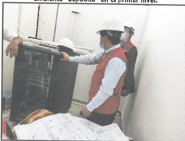
Imagen n.º 28 Bandeja de distribución óptica en ambiente "depósito" en el primer nivel.
