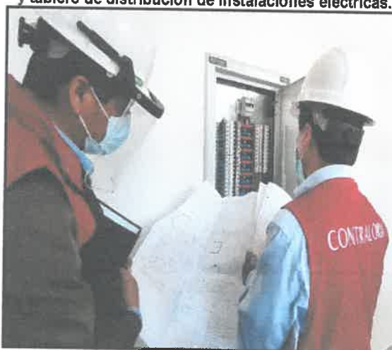
Imagen n.º 27 Cuchillas termo magnéticas en tablero general y tablero de distribución de instalaciones eléctricas.
